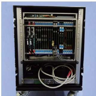
ラック1 指令制御装置
