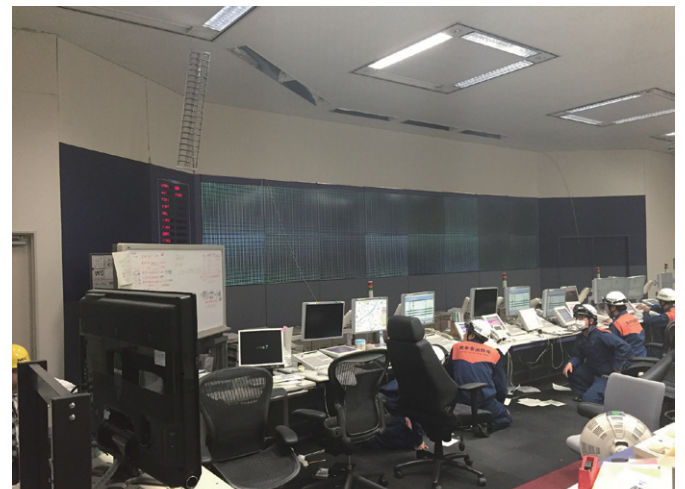
熊本地震本震直後の指令センター状況
