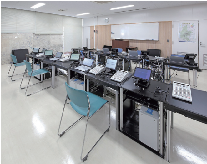
熊本市北消防署会議室に可搬型指令システムを設置
