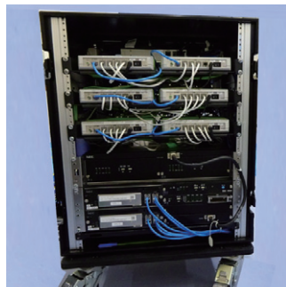
ラック2 指令制御装置
